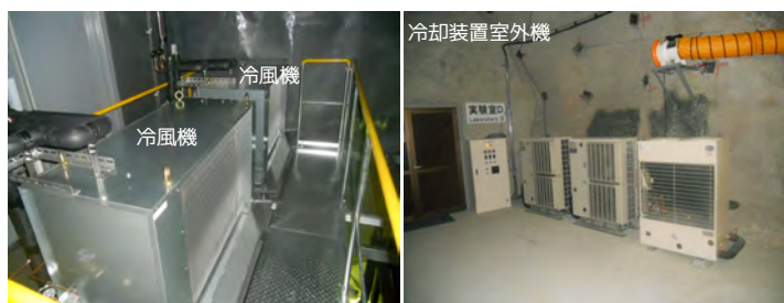
図 1.2: CANDLES III システムに導入された冷却システム。左写真: 実験室を冷却するための 2 台の冷風機。右写真: 実験室外に設置されている室外機。冷風機 2 台の室外機と、冷水機の室外機が設置されている。
